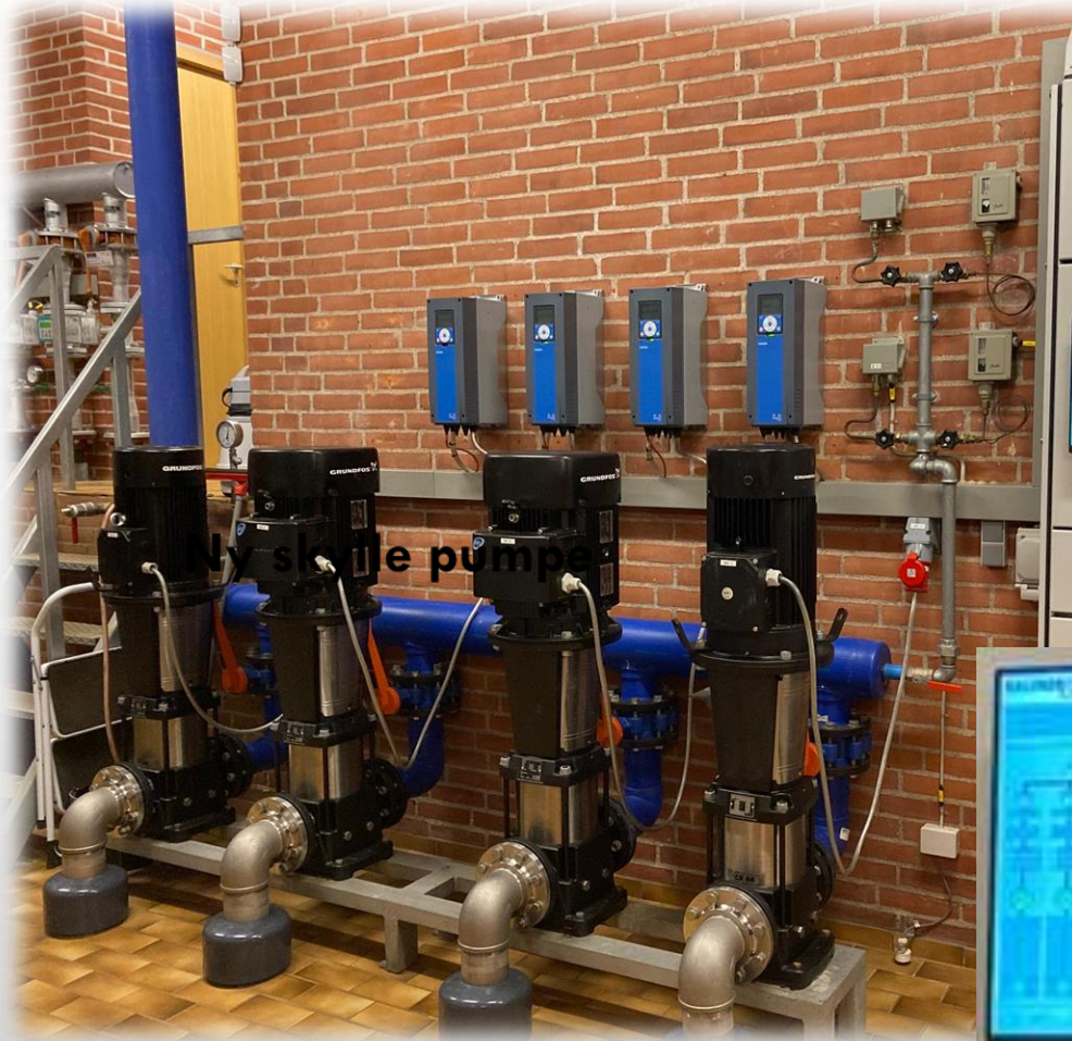
Nye stigrør og frekvensomformere
