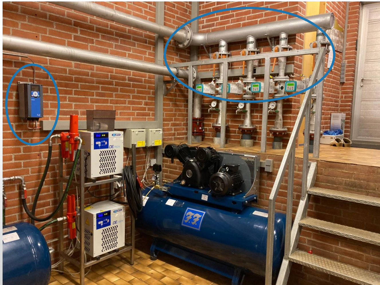
Ny rå-vand manifold med flowmålere
